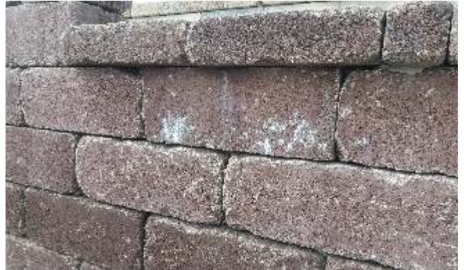
mészkivirágzás a kerítésen
